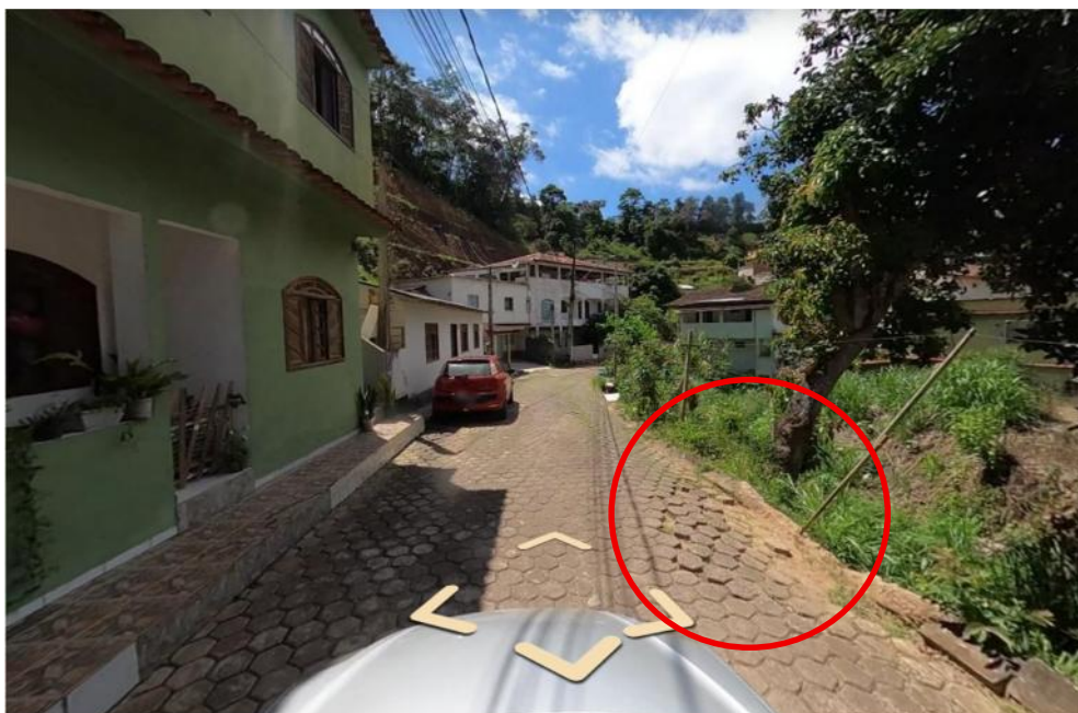
Figura 7 - Rua Elpídio de Souza, pavimentação danificada na borda.
